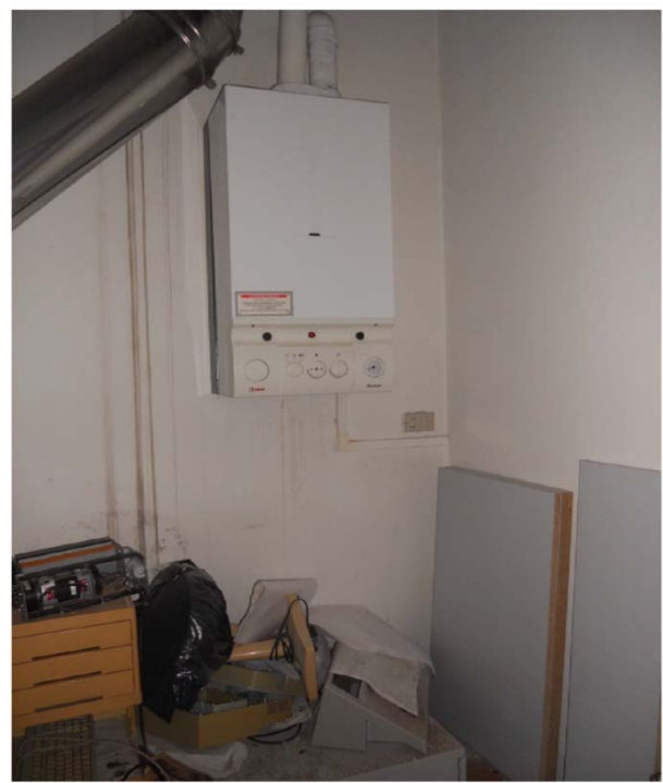
014- vista vano caldaia
